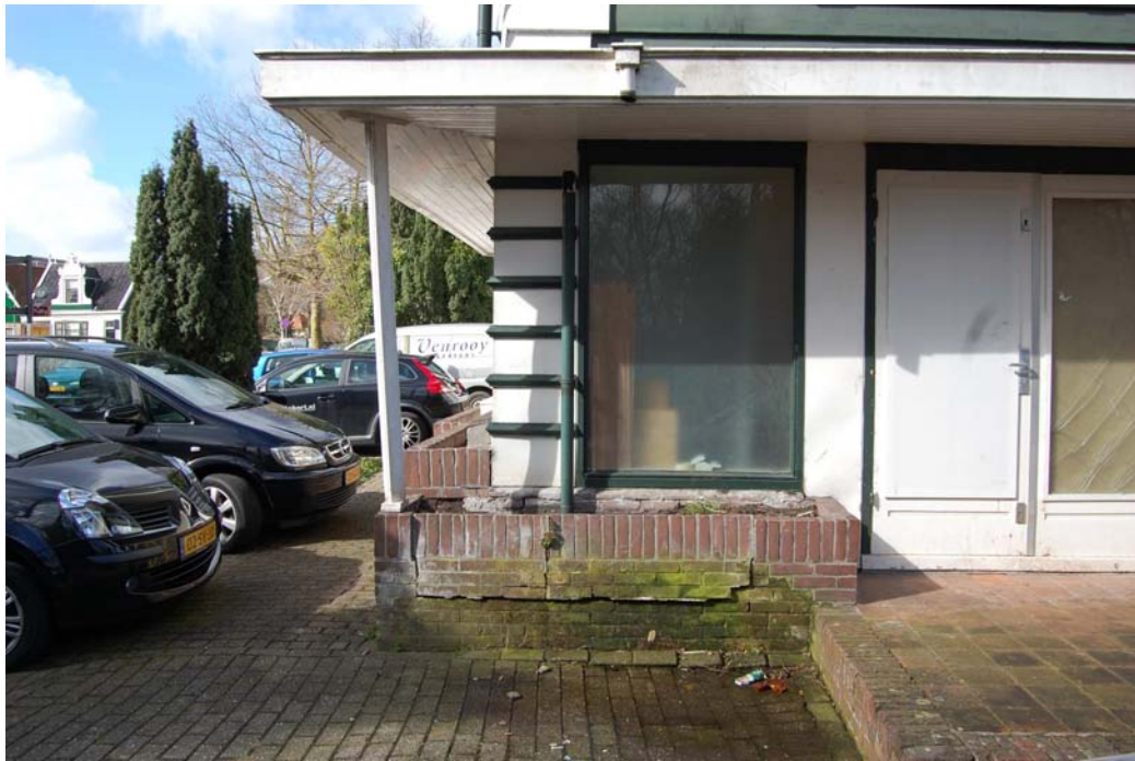
Afb. 29 Detail van de gehavende oostgevel met houten luifel en het terras uit 1926
